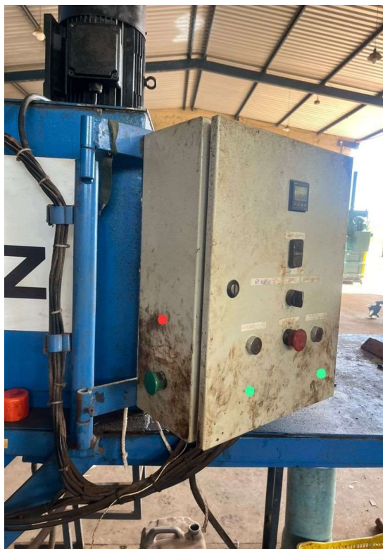
Quadro de comando elétrico e motor prensa
